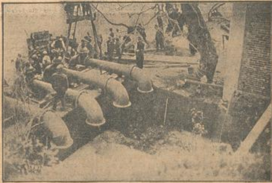
Die Wasserröhren des Pumpwerkes
