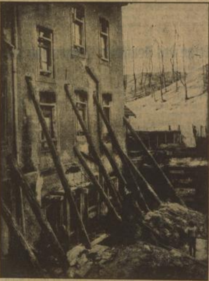
Ein von den Dorfbewohnern gefälltes Haus in Schnappach (Saar), dessen Fundamente durch einen bis unter das Dorf von den Franzosen vortretenden Schacht untergraben worden sind
