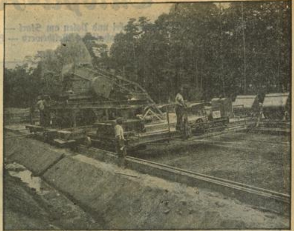
Betonmischmaschine mit dem „Verteiler“, der über die Fahrbahn rollt und den Beton gleichmäßig verteilt
