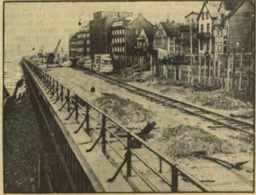
Um die Felsabstürze auf der Insel Helgoland zu verhüten, sind umfangreiche Uferschutzarbeiten notwendig geworden. Auf einer Länge von 150 Meter werden eiserne Spundwände errichtet und mit Beton und Stahlbeton befestigt. Ganz links: Die alten Holzwände, die dem Wasser nur wenig Widerstand boten. Gleichzeitig wird eine neue Promenade angelegt.
