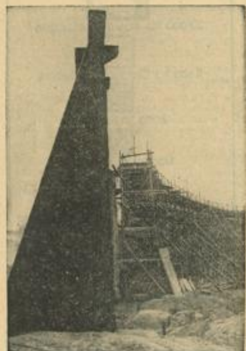
Im Rund des künftigen Hauptkampflages für die Olympischen Spiele 1936 stehen schon die Grundmauern der Tribünen. Der Bau schreitet rüstig vorwärts.
