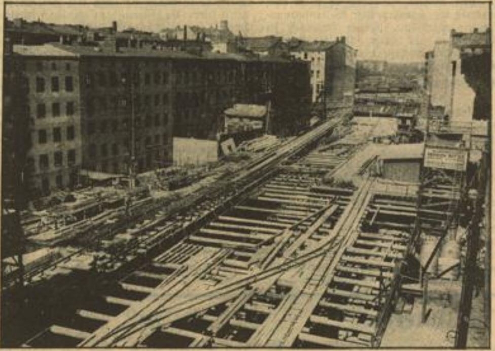
Der Bau der Berliner Nord-Südbahn Die neue Verbindung zwischen den nördlichen Vorortstrecken zwischen Anhalter- und Potsdamer Bahnhof einerseits und Sektiner Bahnhof andererseits wird von der Reichsbahn als Untergrundbahn gebaut. Da die Linie mitten durch das Berliner Häusermeer führt, ergab sich die Notwendigkeit, zahlreiche Gebäude abzutragen, an deren Stelle noch fertiggestellte des Bahnbau's neue Wohnhäuser treten werden. Das Bild zeigt die Baustelle in der Nähe des Sektiner Bahnhofs und gibt einen interessanten Ueberblick über die künftige Tunnelbreite, die der Größe der Berliner S-Bahnwagen entspricht. Photo: Pressebild-Zentrale 111-Bildstock
