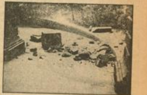
Der Unterführungsweg zum Schloßgarten, auf dem die Trümmer der betriebsgeführten Stielbrüstung zu sehen sind.
