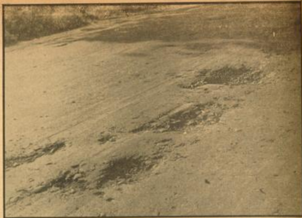
Derartige Löcher in der Straßendecke verursachen besonders starke Verkehrsererschütterungen, die vom Zentrum der Erschütterung aus durch den Boden zu den Häusern weitergeleitet werden.
