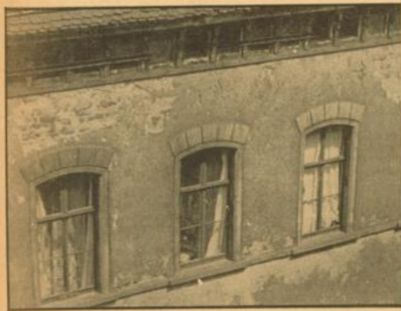
Die Verkehrsererschütterungen beschädigen nicht selten die Fassaden der Häuser, die ihnen besonders ausgesetzt sind. Unser Bild, das an einem Hause in einer großen Durchgangsstraße aufgenommen wurde, zeigt deutlich das schon weit fortgeschrittene Abdrücken des Putzes an der Hauswand.
