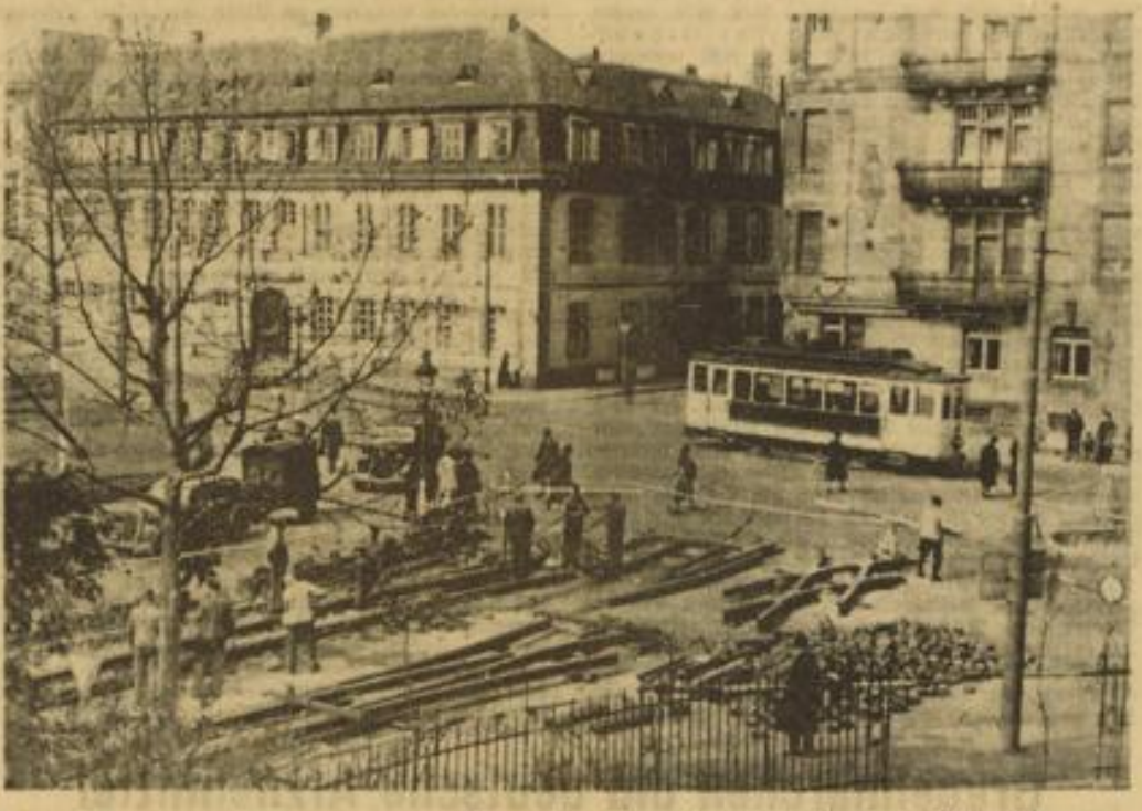
Blick auf den Verkehrspunkt an den Haltestellen „Bismarckstraße“ während der Gleisarbeiten (Aufnahme: Fritz Haas)
