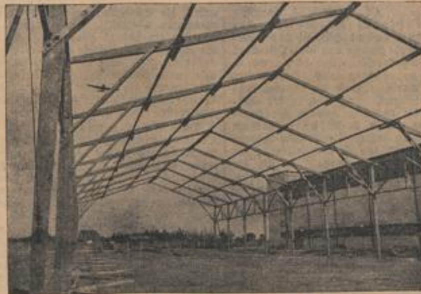
Ein fertiges Gerüst für eine der zulässigen Hallen — nur die Bespannung fehlt noch
