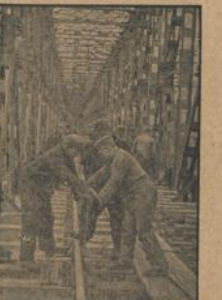
Auf der neuen Nordbrücke über die Weidloch bei Diepholz werden durch unsere Heeresflugpioniere die Pfeile befestigt. Wie bereits berichtet, ist diese Brücke jetzt fertiggestellt, so daß der Inverkehr am nächsten durchgeführt werden kann. (Presse-Verlag, Sonder-Multicolor-Dr.)
