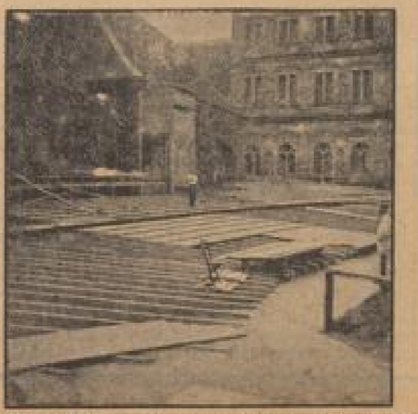
Der Unterbau zu den wesentlich vermehrten, nunmehr 1634 Sitzplätzen des Schlosshofes, ist beinahe fertig.
