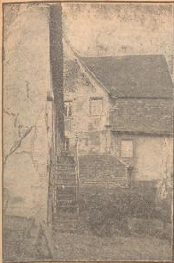
Überall Risse im Mauerwerk
