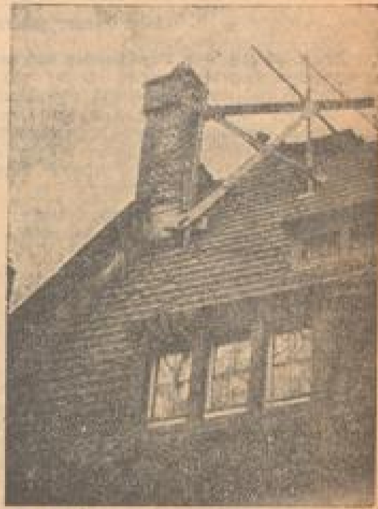
Über der vielen in Raftatt durch das Unwetter beschädigten Dächer, der Turm vor dem Unwetter geschützt wurde.
