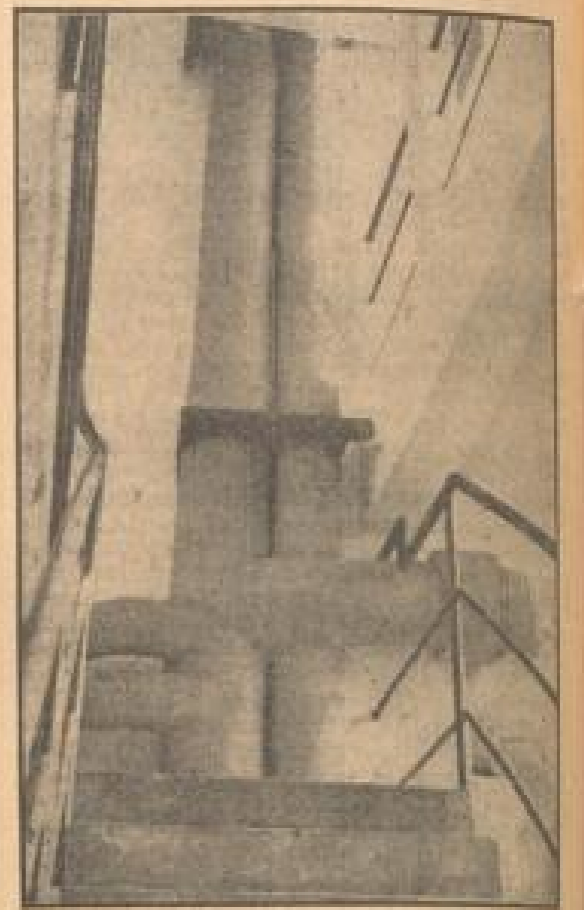
Verteilungsrohr für die Sole im Kühlhaus
