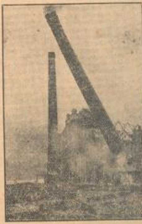
Im Hofraum der Reichsbauverwaltung des alten Reichstages in Berlin wurden die letzten Schoensteine, die eine Höhe von rund 9 Metern haben, niedergelassen. Die Arbeit ging sehr langsam vor sich, wie man aus dem Bild sehen kann. Die Arbeiter sind sehr vorsichtig, denn die Steine sind sehr schwer und müssen sehr sorgfältig abgesetzt werden. (Schwarz, R.)
