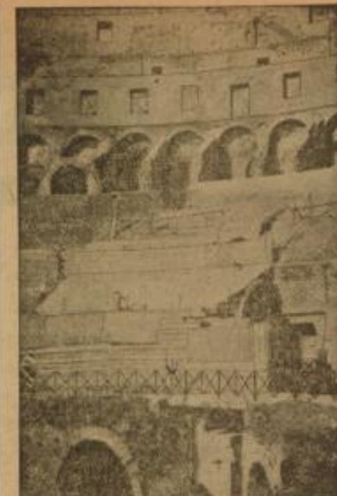
Das Kolosseum in Gefahr. Am Kolosseum in Rom wurden Stützungen vorgenommen, da sich an einigen Stellen die Gefahr eines Einsturzes zeigt.
