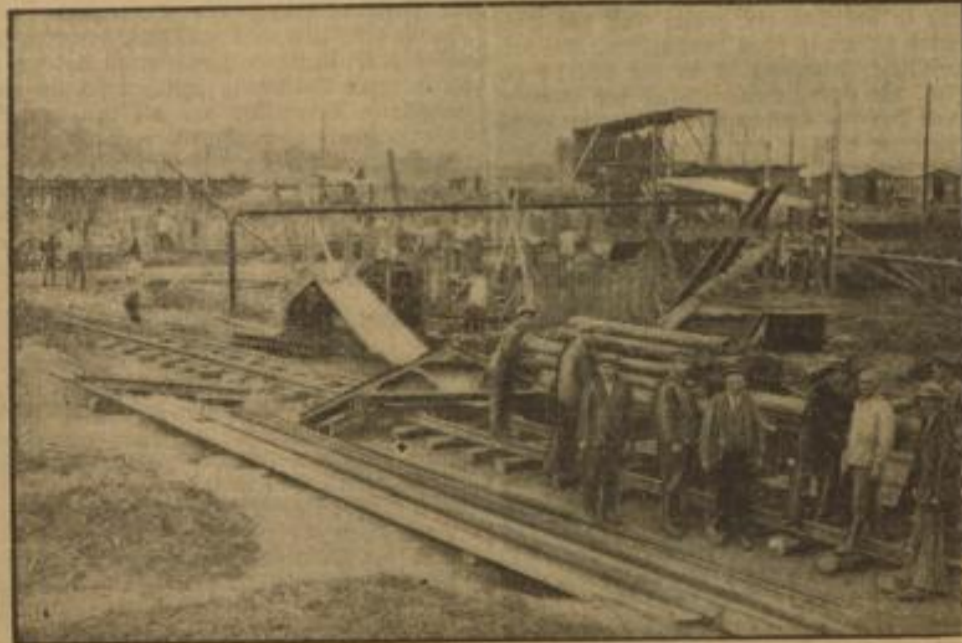
Die erste Autobahn Frankfurt-Heidelberg im Bau. Die Vorarbeiten für die neue Reichsautobahn in der Nähe von Frankfurt, wo jedoch feierliche Arbeitsbeginn in Anwesenheit des Reichsfinanziers erfolgte.
