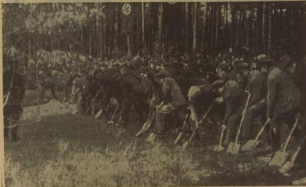
Nachdem der Führer in Unterhaching die Parole ausgegeben hatte, wurde im ganzen Reich die große Offensive gegen die Arbeitslosigkeit aufgenommen. Auf unserem Bilde sieht man den Baubeginn an der Reichsautobahn Berlin — Industriegebiet im Hämeler Wald (zwischen Hannover und Braunschweig).
