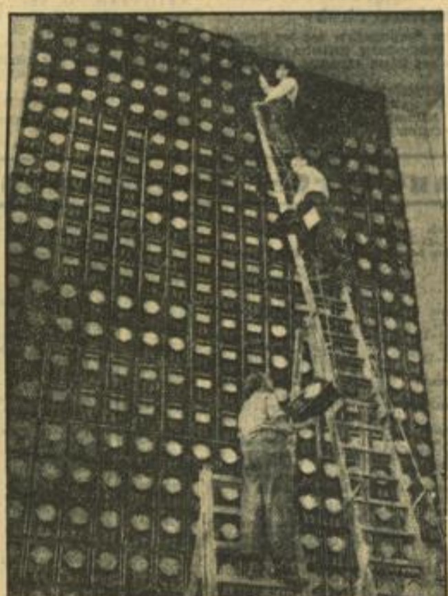
Berlin rüstet für die große Funkausstellung, die am 17. August am Kaiserdamm eröffnet wird. Unser Bild zeigt die Errichtung einer Wand von 1000 Volksempfänger-Geräten.
