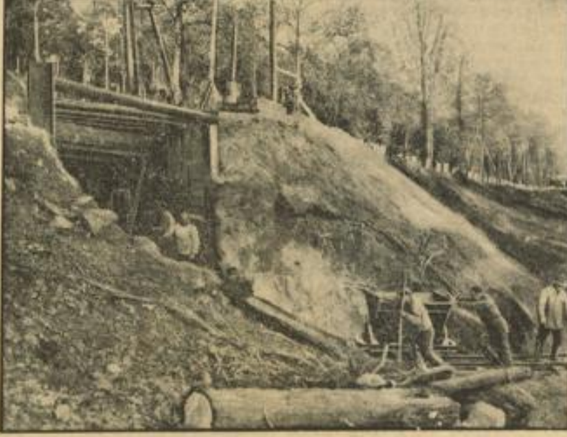
Viele Hände arbeiten eifrig an der Verlegung der Straße am Kilometerberg zwischen Wannee und Potsdam, die als wichtige Berliner Ausfallstraße durch Zerschlagung der Steigungen eine willkommene Verbesserung für den Verkehr erfährt.
