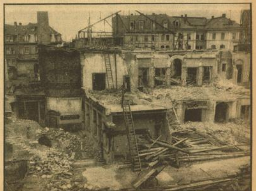
...der Abbruch erfolgte bereits. Bald werden hier 65 Familien gesunde Wohnungen beziehen können Anl. t Hochbasant (1), Franck (2)
