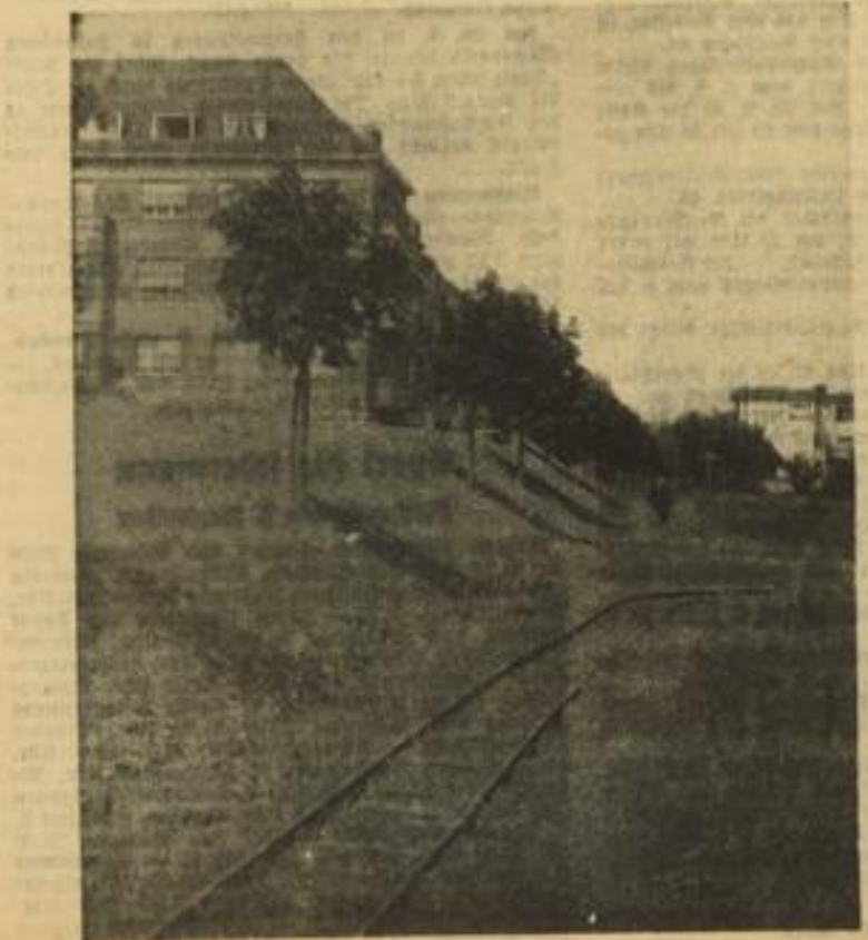
Bild links: Der später für die Befestigung von Dämmen benötigte Mutterboden wurde auf unbenutzten Straßenzügen in Sicherheit gebracht, nachdem man ihn im Zuge der neu aufgeschütteten Sedenheimer Straße abgehoben hatte.
