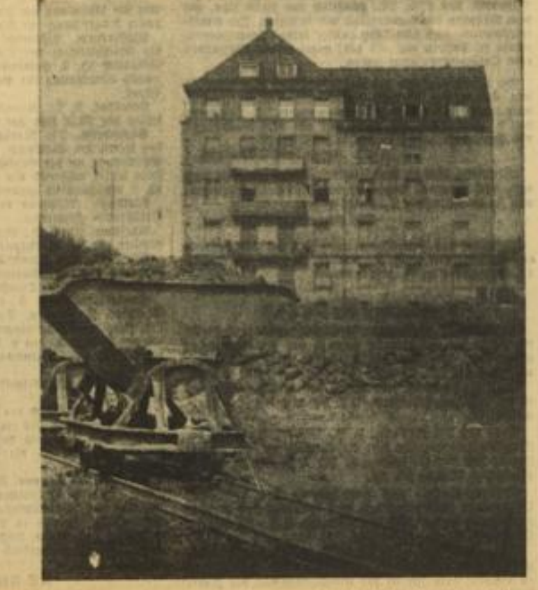
Bild rechts: Überall auf dem Baugelände längs der Augusta-Anlage trifft man Feldbahnen und alles steht im Zeichen der Kipporen, die das Anfüllmaterial herbeischaffen.
