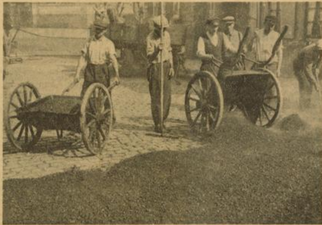
Auf den Straßen mit Kopfsteinpflaster wird der mit einem Bindemittel durchsetzte Splitt aufgetragen und splitt festgewalzt, so daß eine glatte Straßenoberfläche entsteht. Aufnahme: Jütt
