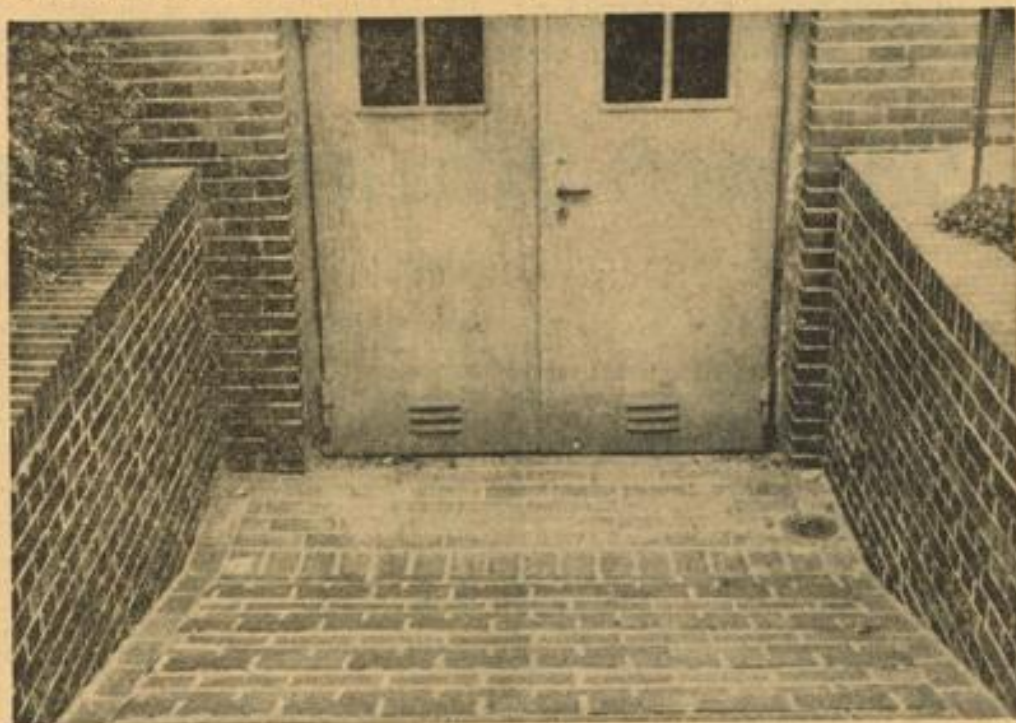
Die „Kellergarage“, wie sie nicht sein soll: die Zufahrt ist zu steil, die beiden Mauern links und rechts bilden eine „Schlucht“, durch die das Bild des Vorgartens völlig zerstört wird. (Arch.: WNZ (3))
