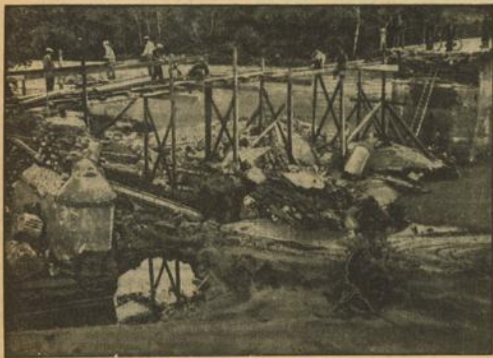
Schwere Verwüstungen durch Hochwasser in Oberitalien. Weltbild (M) Durch anhaltende Regenfälle sind die oberitalienischen Flüsse überaus angeschwollen, daß große Landströcke überschwemmt und zahlreiche Häuser und Brücken zerstört wurden
