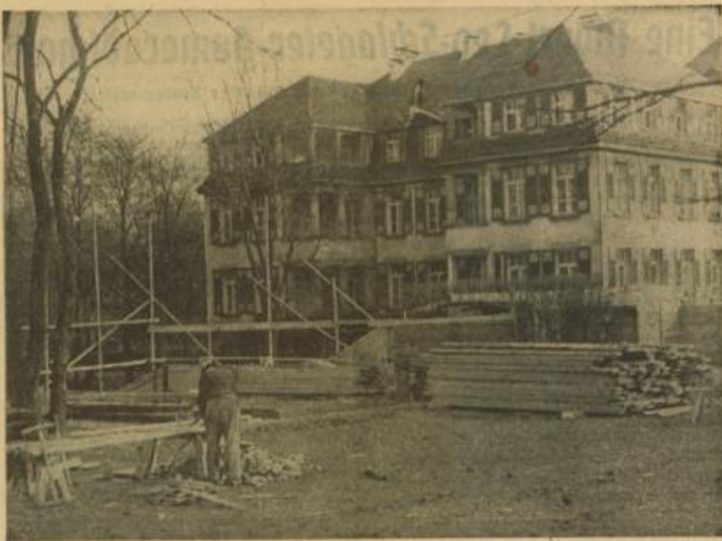
Wie wir schon berichten konnten, wird auf dem Gelände des Städtischen Krankenhauses in die am Neckar liegende Front ein weiteres Gebäude eingezogen. Es handelt sich hier um ein Ärzte- und Schwesternwohnhaus...
