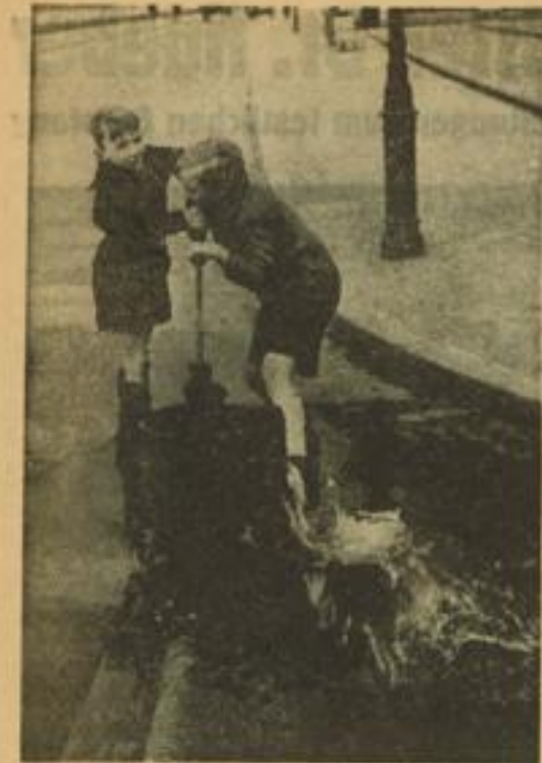
Bei einem Wasserrohrbruch galt es, größere Wassermassen aus dem an der Bruchstelle gegrabenen Loch zu pumpen. Zwei Pimpfe fanden es als eine sehr angenehme Ferienunterhaltung, die Pumpe zu bedienen, um so den Handwerkern etwas zu helfen. Aufn.: Jütte
