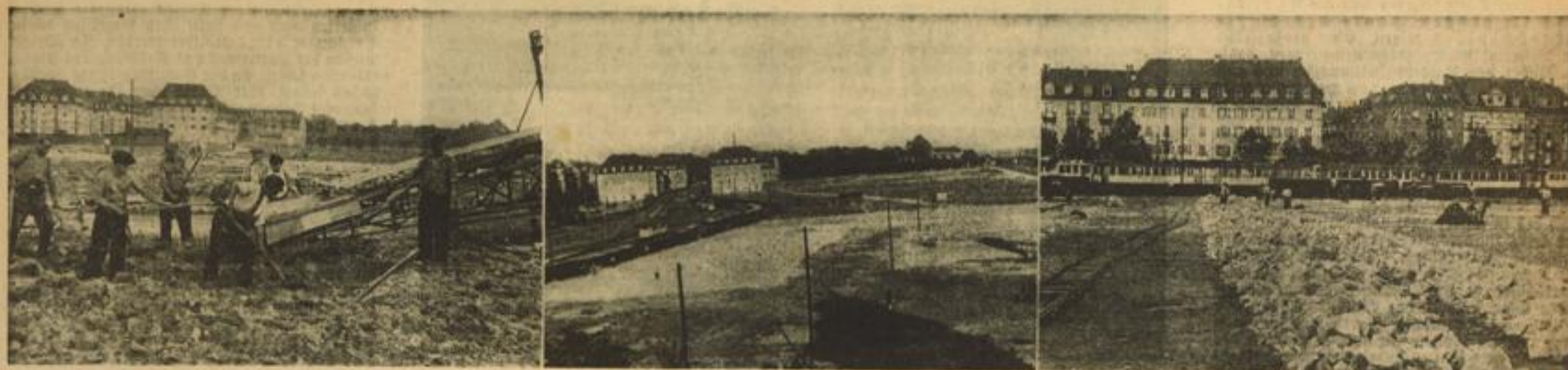
Die Arbeiten auf dem Platz längs des Adolf-Hitler-Ufers sind in vollem Gange. Der mit dem Bauschutt aus den Plankendurchbrüchen I und II aufgefüllte große Platz wird gegenwärtig befestigt. Zu diesem Zweck wird die obere Schicht abgetragen und mit Steinen bestückt. Der unter Zuhilfenahme von Transportbändern weggeschaffte Grund wird zu Auffüllungs-Aufnahmen: Jütte (3)
