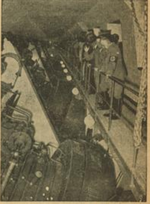
Das Unterwasserkraftwerk an der Iller im Betrieb Blick auf die unter Wasser befindlichen Maschinenanlagen des neuen Kraftwerkes an der Iller. Im Vordergrund Gauleiter Wagner bei einem Besichtigungsrundgang nach der Eroffnung.
