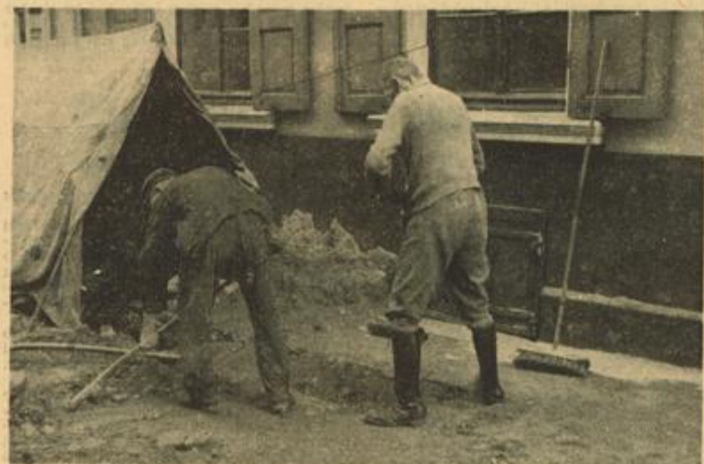
So ein Zelt kann bei Regenwetter schon nützlich sein. Leider können aber die Straßenarbeiter darin kaum Zuflucht vor der Nässe suchen, da das Zelt in erster Linie das ungestörte Arbeiten an unterirdischen Leitungen ermöglichen und das Eindringen von Nässe in die Schachtanlagen verwehren soll.
