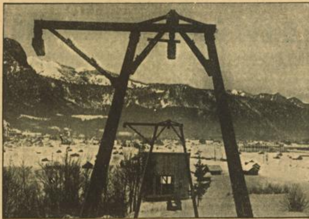
Neuer Skiliftzug von Garmisch-Partenkirchen zur Neunerhütte. Blick auf die im Bau befindliche Talstation in Garmisch-Partenkirchen. Schirner (M)
