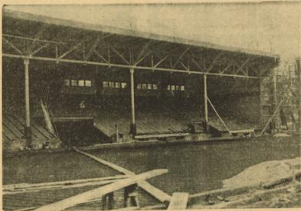
Ein Bild von der Baustelle des neuen Mannheimer Eisstadions. Im Hintergrund sieht man die gewaltige Tribüne (so etwas sollte man auch im Stadion haben — sagen die Sportler mit neidischen Blicken), während im Vordergrund das ausgedehnte Röhrensystem erkennbar ist, das zur Herstellung der Eisfläche dient. In etwa vierzehn Tagen hofft man, den Eislaufbetrieb aufnehmen zu können und in vier Wochen soll dann die offizielle Eröffnung des Eisstadions erfolgen. Aufnahme: Hans Jütte
