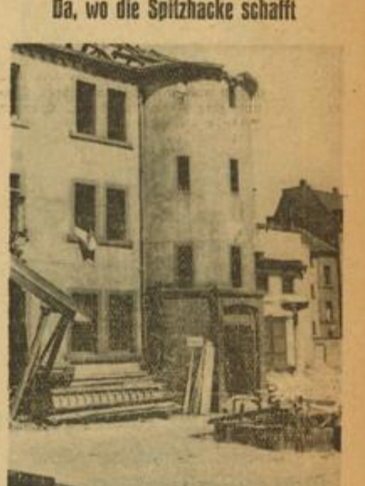
Wenn auch an der Straßenfront nicht viel von den Abbrucharbeiten von O 6 zu sehen ist, so geht der Abbruch der Häuser doch unentwegt weiter. Unser Bild zeigt einen Ausschnitt aus dem Innenhof mit den Resten des Turmes. Aufn.: Hans Jütte
