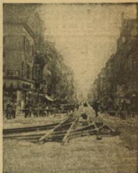
So mündet das von der Breitenstraße kommende Straßenbahngleis in die neue Verkehrsinsel ein, die in Zukunft den Brückenkopf auf der Seite zur Innenstadt hin beherrschen wird.
