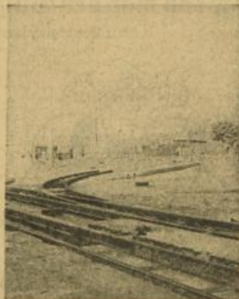
Die ersten neuen Anschlußstücke in der Breitenstraße wurden jetzt angebracht, nachdem man die alten Gleise herausgerissen hatte.
