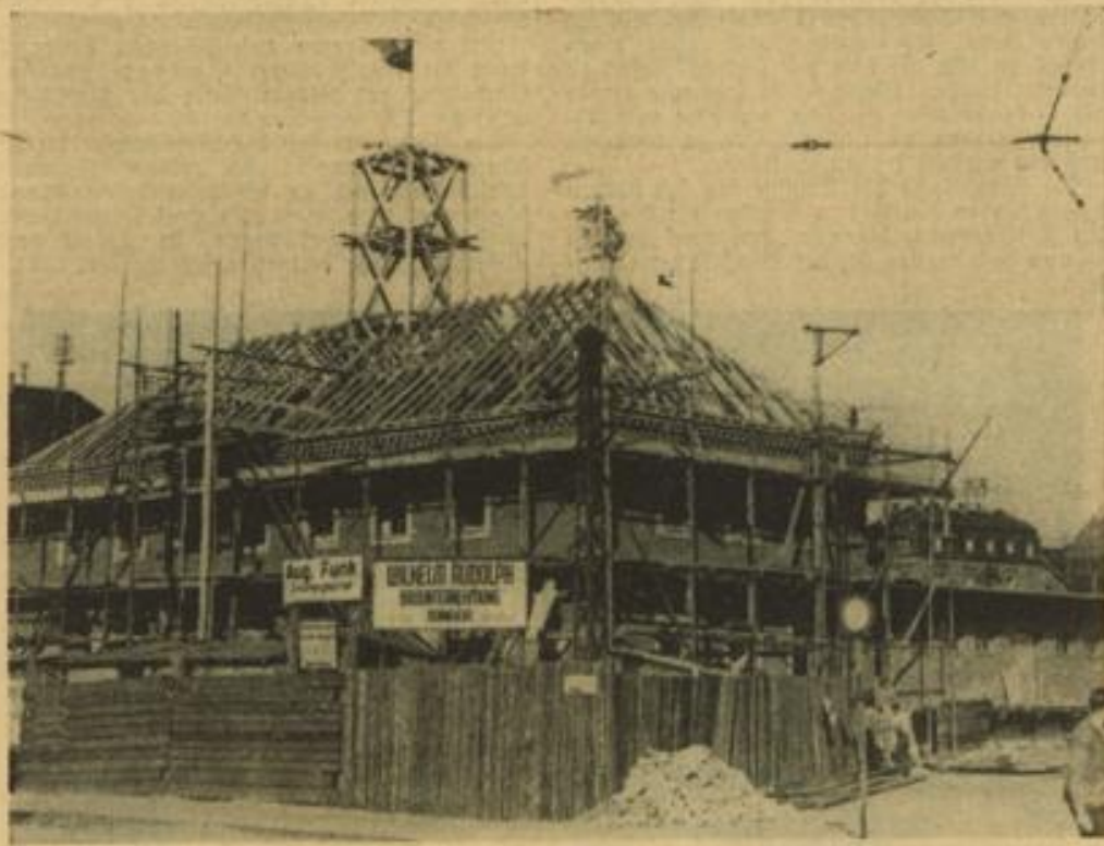
Auf dem OEG-Bahnhof Mannheim-Neckarstadt der A-Linie nach Weinheim wurde — wie wir bereits berichteten — der Richtbaum gesetzt. Aufnahme: Hans Jütte
