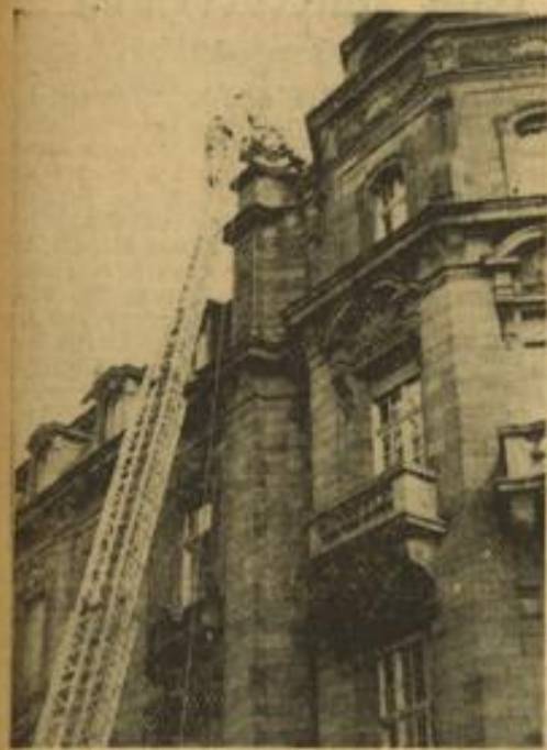
Die Feuerwehrleiter am Polizeipräsidium: Diesmal rückte man aber keinem Brand zu Leibe, sondern den Bronzefiguren über dem Dache, die man beim Bau als Zierde angebracht hatte. Die Schiffe sind bereits der Metallspende geopfert, auch die „Justitia“ wird folgen, die allerdings beim Herunterholen mehr Schwierigkeiten bereitet, als die kleineren Schiffe. Aufn.: Fritz Haas
